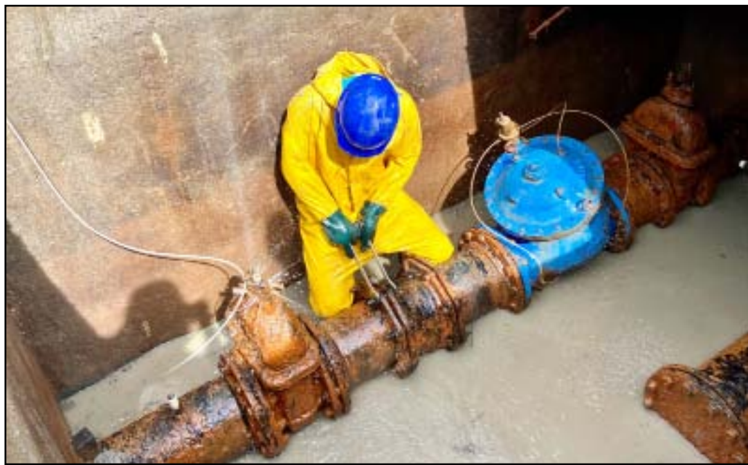
Nova Iguaçu recebe instalação de válvulas redutoras de pressão para prevenir vazamentos
